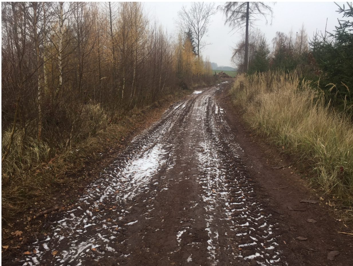
Foto 1 – stav komunikace za ZÚ (proti směru staničení) Celkový pokles se zamezením odtokových poměrů, vytlačené krajnice
