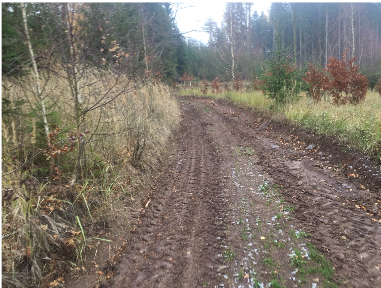
Foto 2 – km cca 0.130, pokles komunikace vůči terénu, stav kolejí
